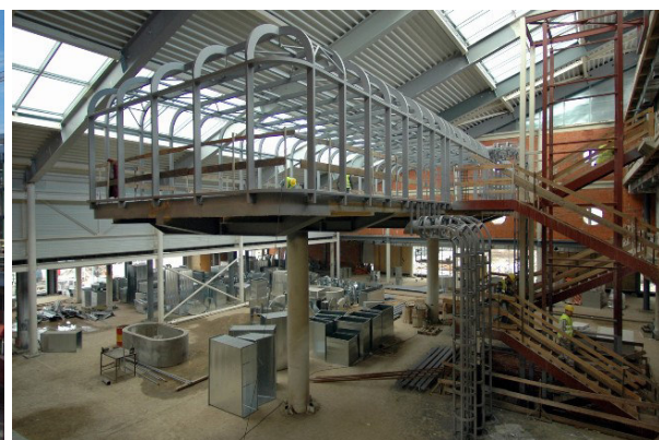
Obr. 18 Ocelová konstrukce interiérů, zavětrování táhly Macalloy, trapézové plechy, prosklené plochy
